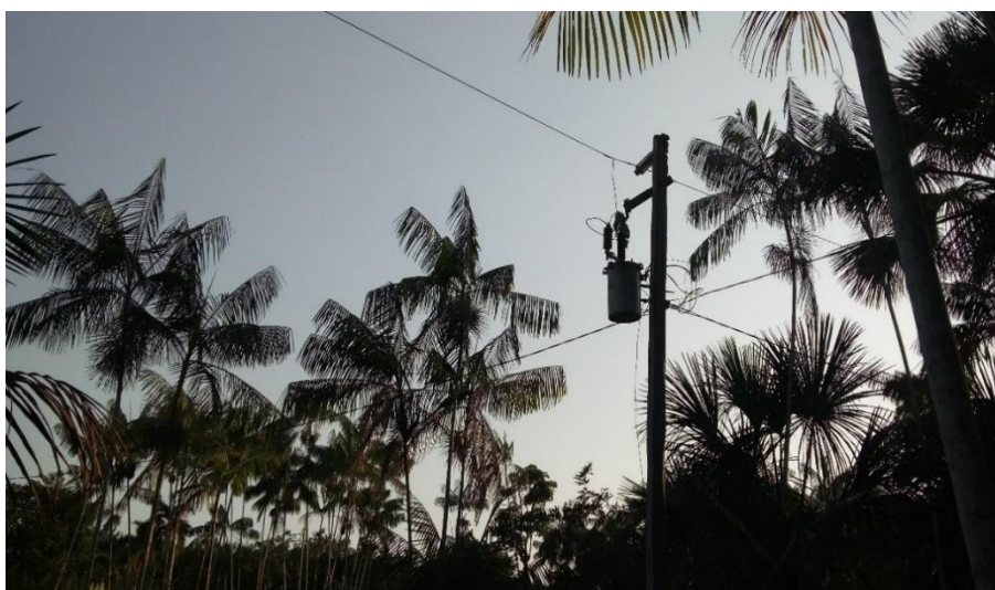
Figura 9— Poste de madeira com transformador dentro do sítio ribeirinho.
