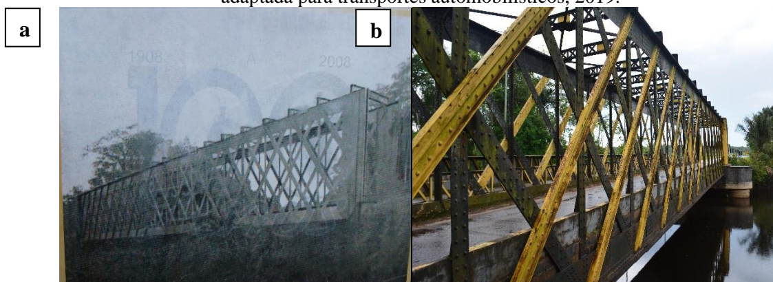
Fig. 14: (a) Ponte metálica do Livramento em Igarapé-Açu, 1908; (b) Ponte metálica do Livramento adaptada para transportes automobilísticos, 2019.
